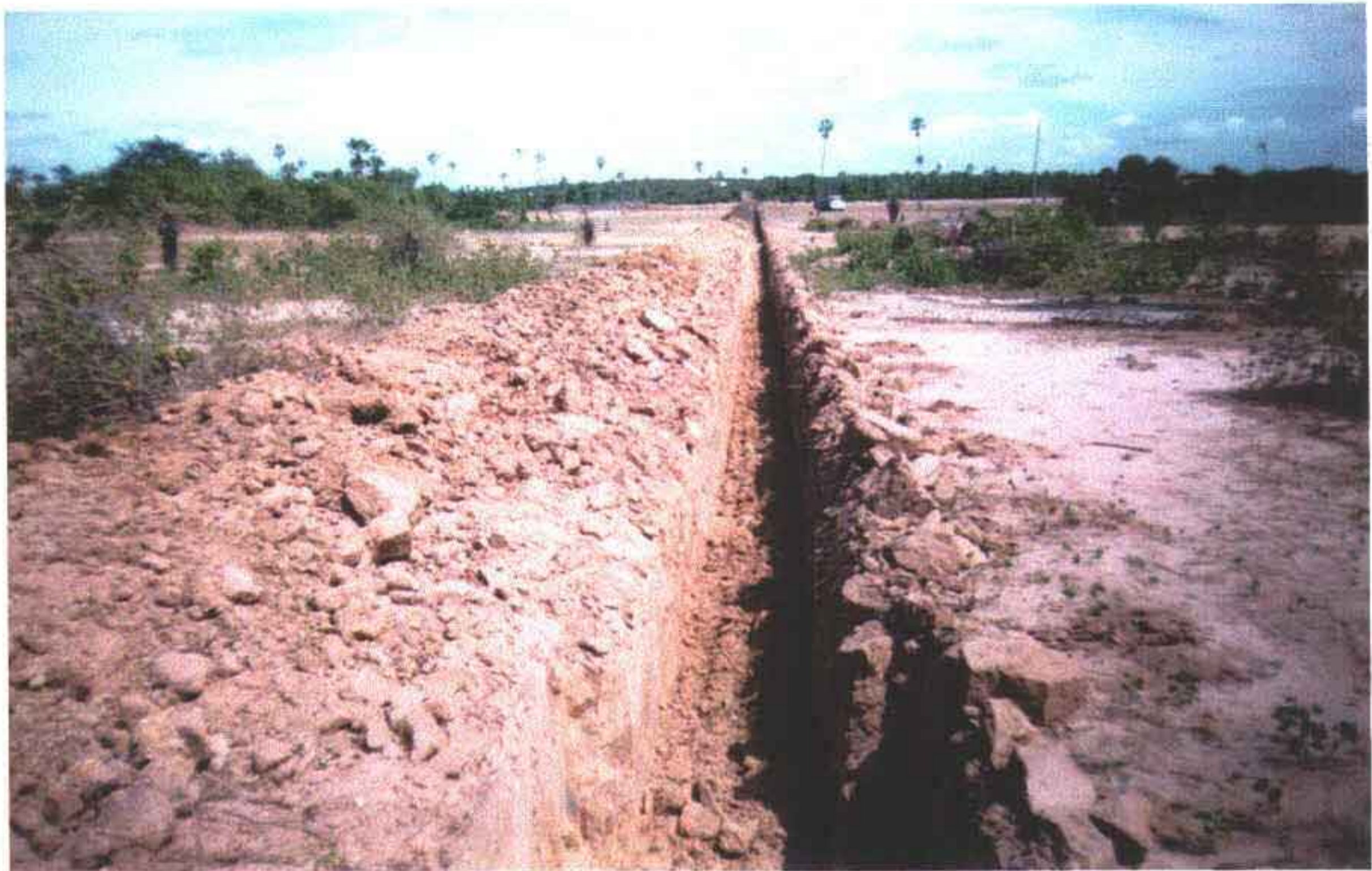
Foto 03 – Vala escavada faltando a regularização do fundo.
