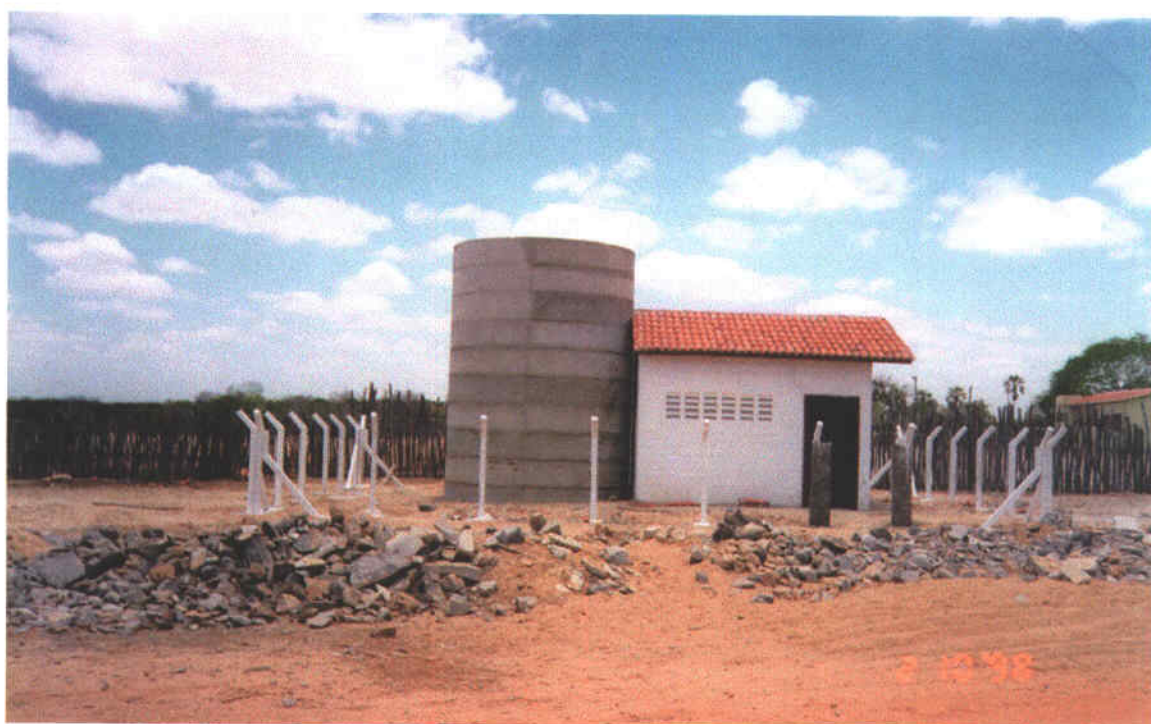
Foto 29 – Estação elevatória EE-3 – Casa de bombas e reservatório de 50 m 3 .
