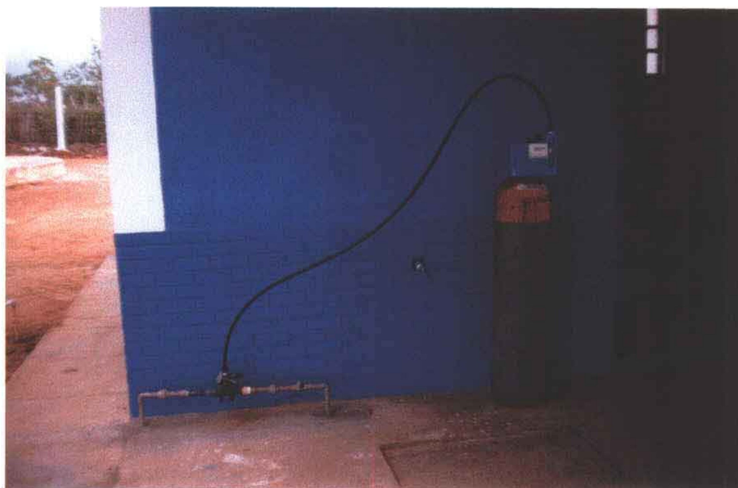
Foto 29 – Cloro gasoso injetado após a filtração.
