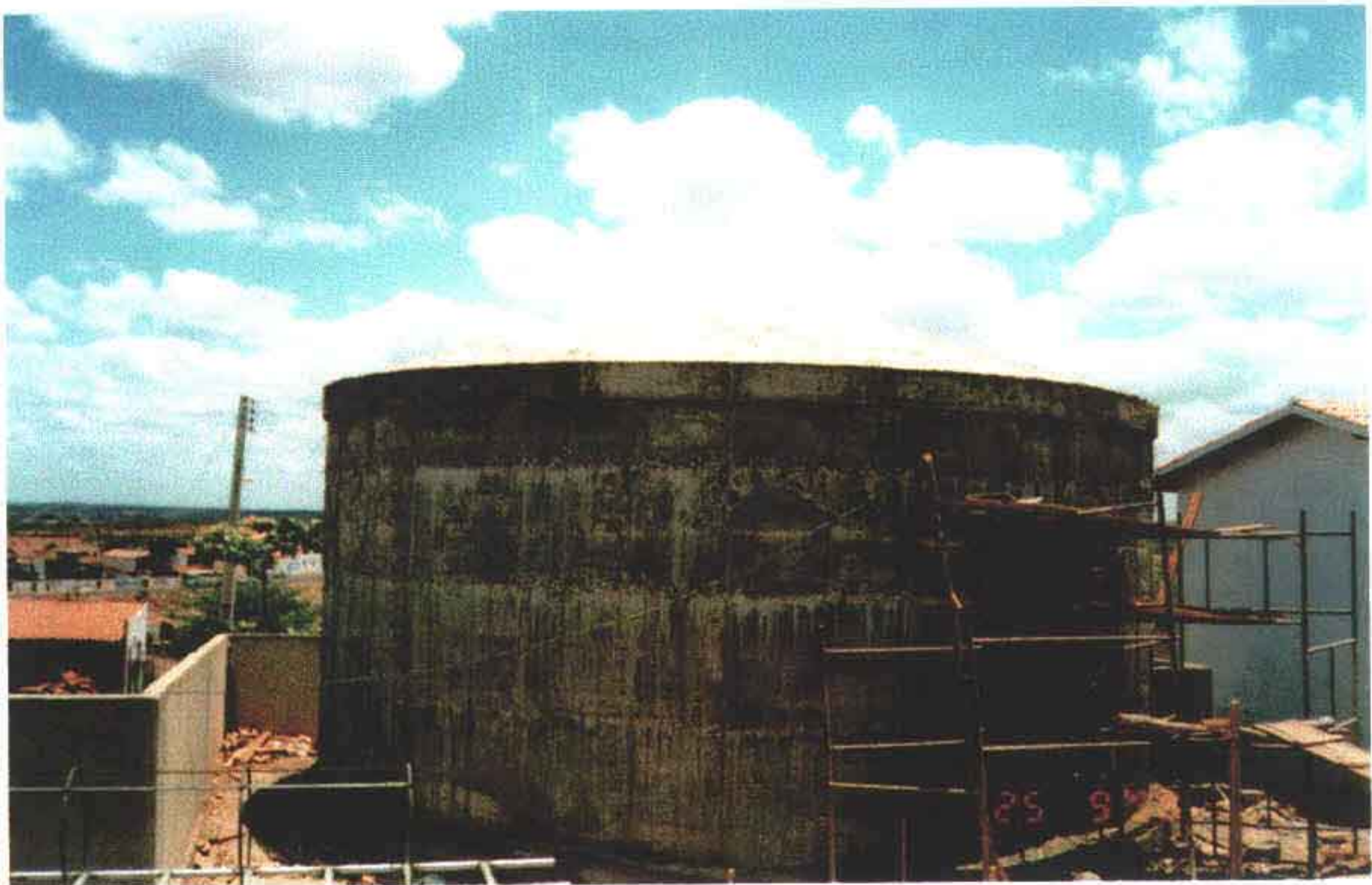
Foto 26 – Reservatório apoiado 200 m 3 .
