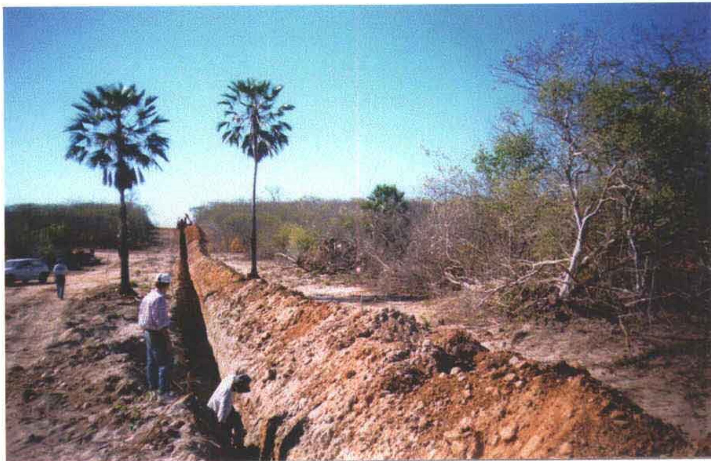
Foto 07 – Valas escavadas com profundidades inferiores as de projeto, sendo refeitas nas estacas 879 e 735 respectivamente.
