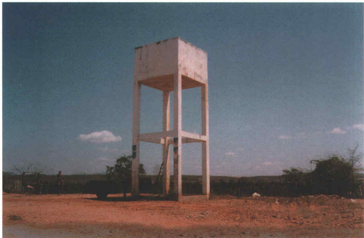
Foto 41 – Reservatório existente no povoado de açude dos Pinheiro, destino final da adução.
