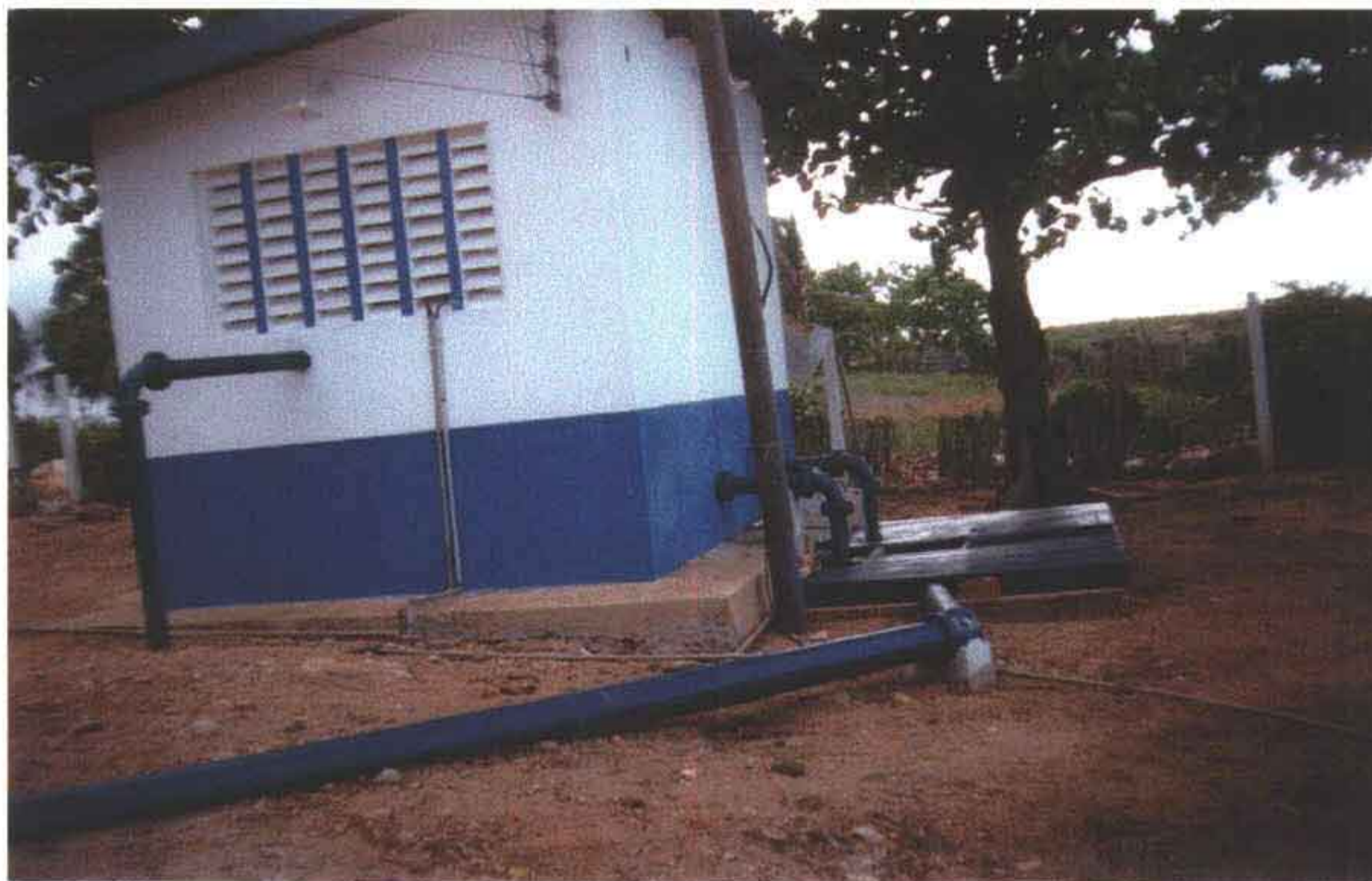
Foto 30 – Estação elevatória e reservatório enterrado. Capacidade 25 m 3 .
