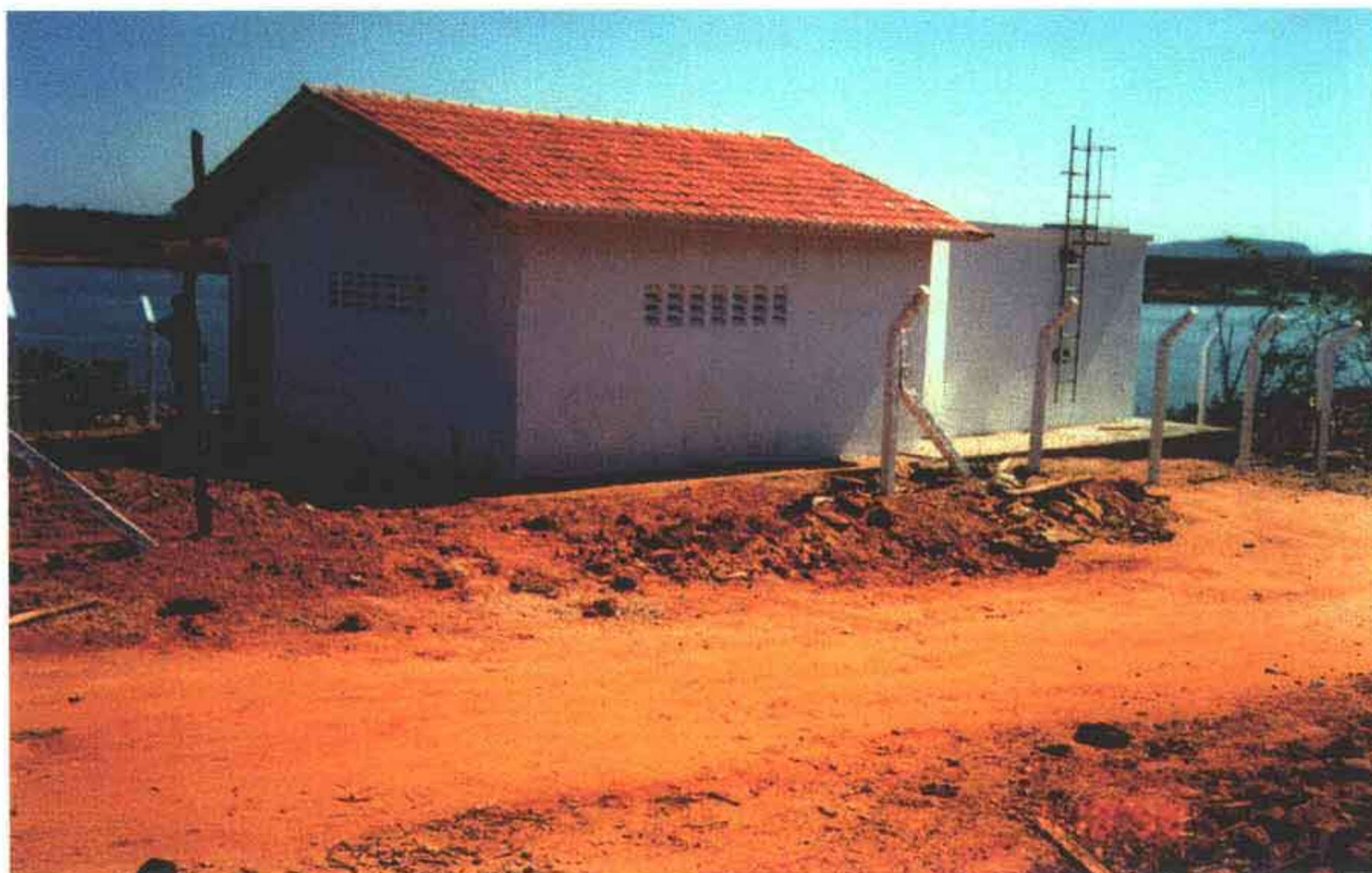
Foto 13 – Vista da estação EE-2.
