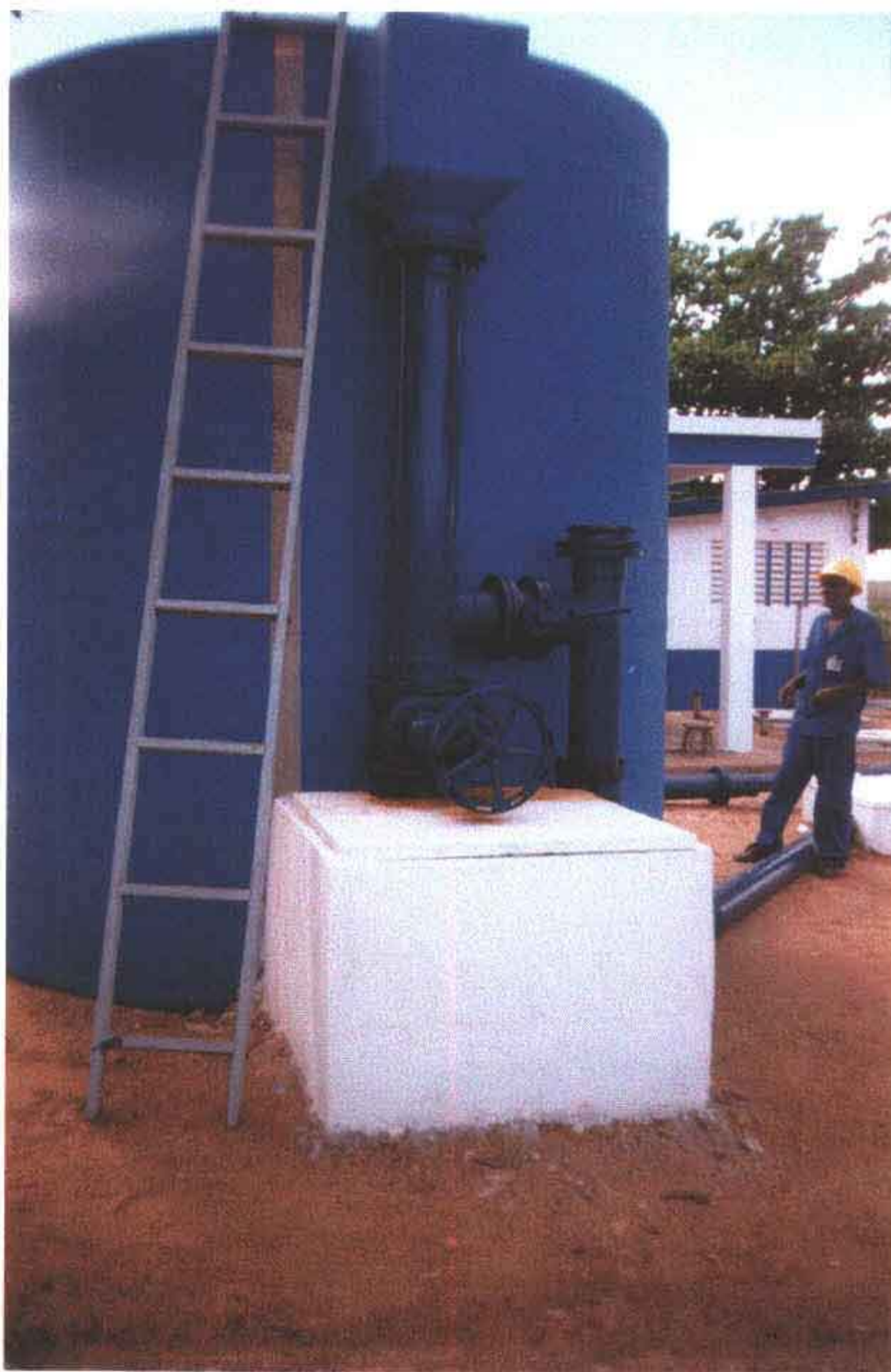
Foto 31 – Filtro de fluxo ascendente. Capacidade 53 m 3 /h, tipo Henfibra.
