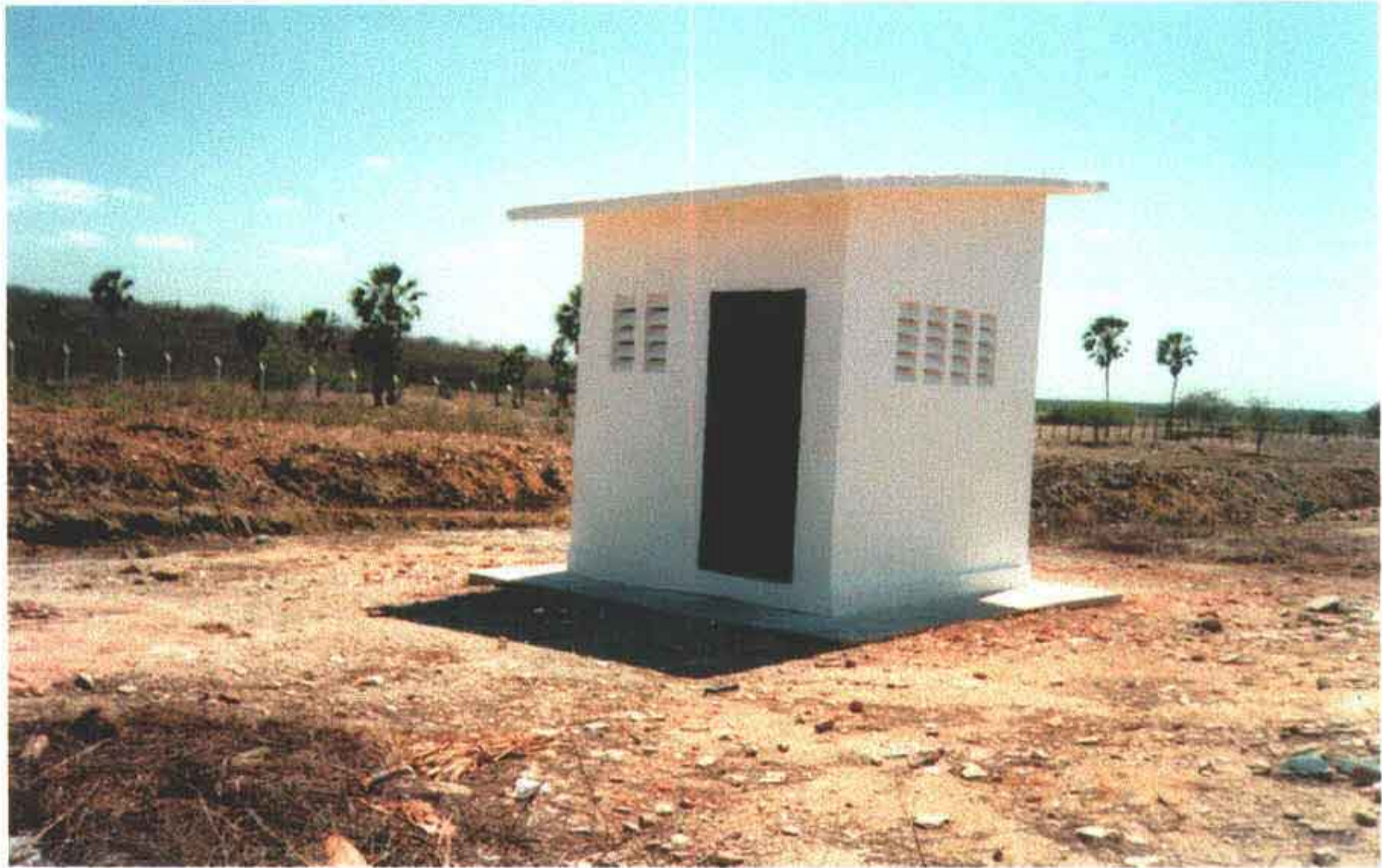
Foto 19 – Casa de comando das bombas na captação na margem do canal do trabalhador.
