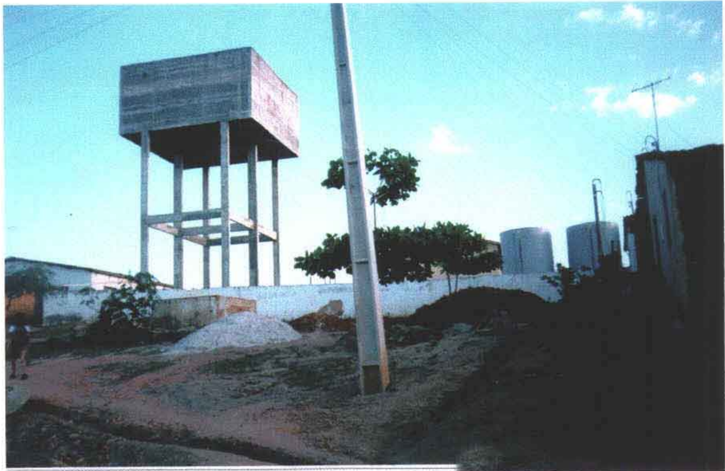
Foto 31 – Reservatório elevado de 200 m 3 construído pela Prefeitura na área da ETA.
