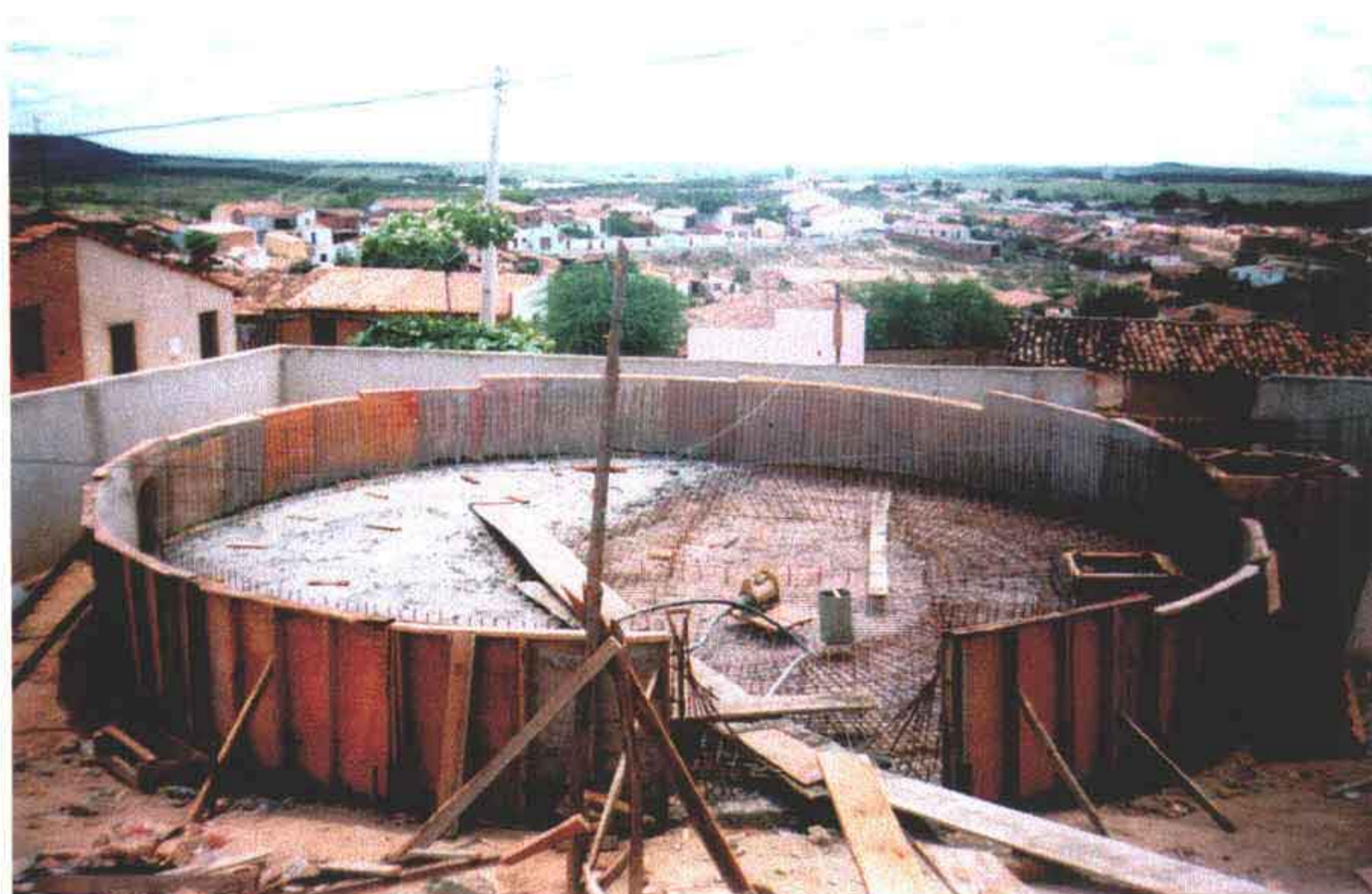
Foto 20 – Concretagem do fundo do reservatório apoiado de 200 m 3 da estação elevatória na ETA.
