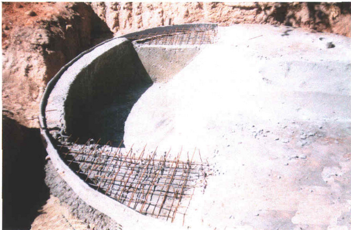
Foto 37 – Detalhe do poço de sucção do reservatório apoiado de 80 m 3 .
