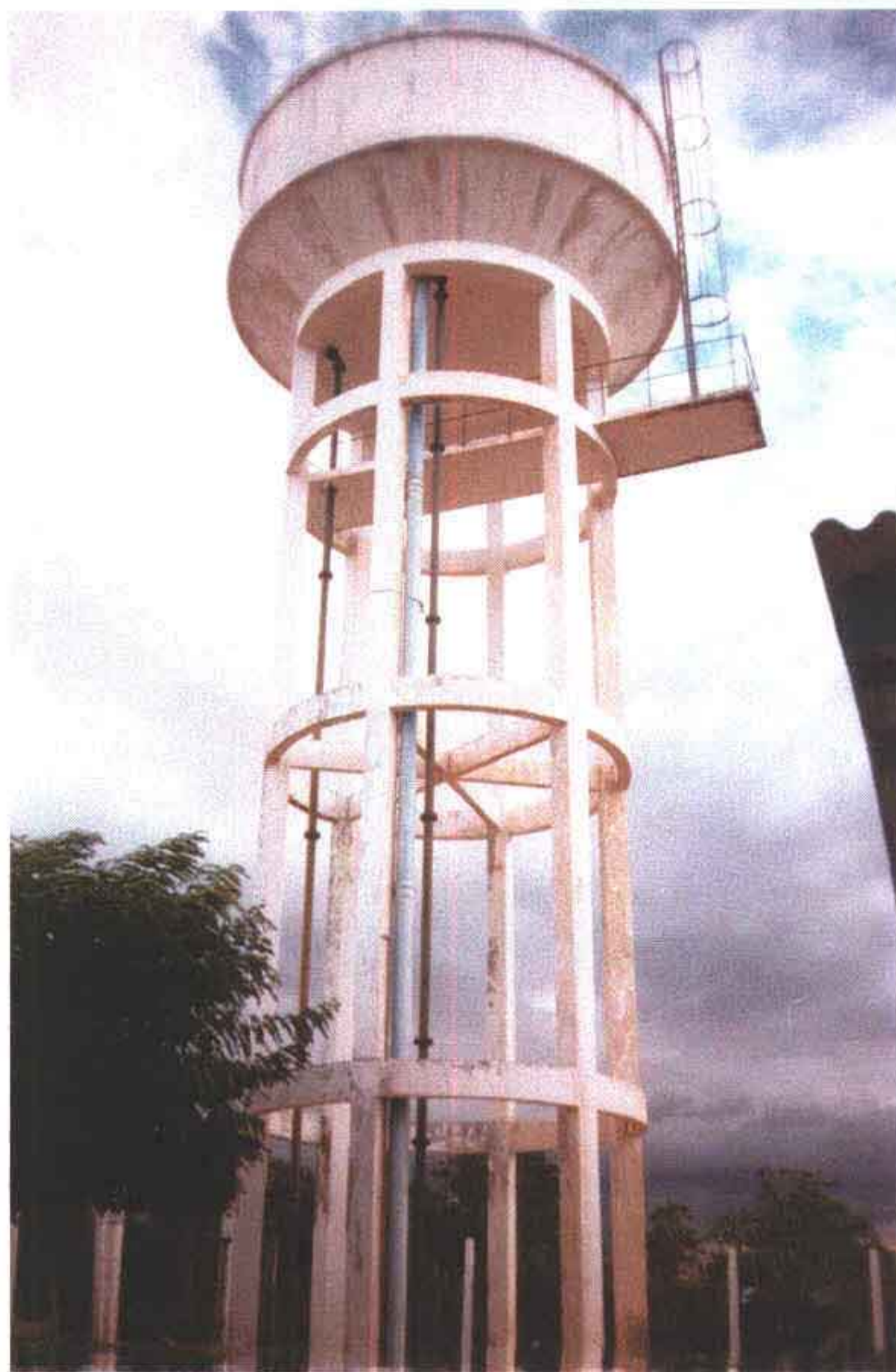
Foto 30 – Reservatório elevado. Capacidade 100 m 3 .
