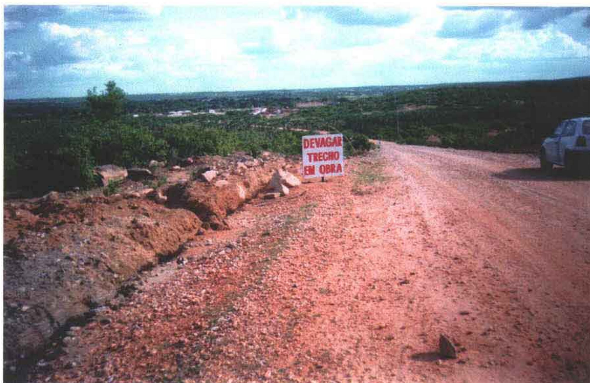
Foto 02 – Sinalização de advertência.
