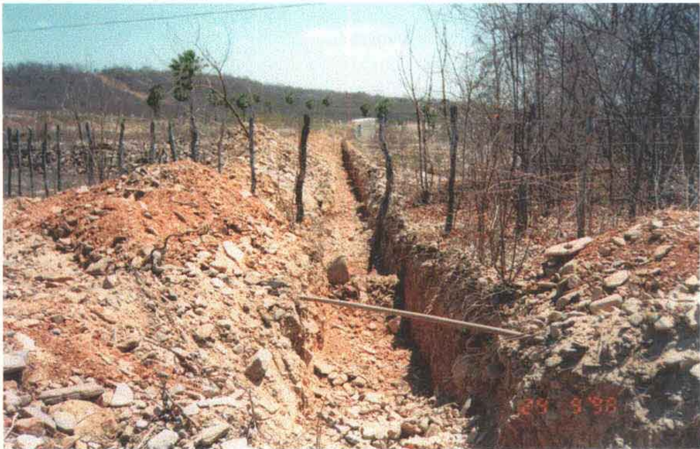
Foto 14 – Escavação de parte da vala próximo a casa de comando na captação.
