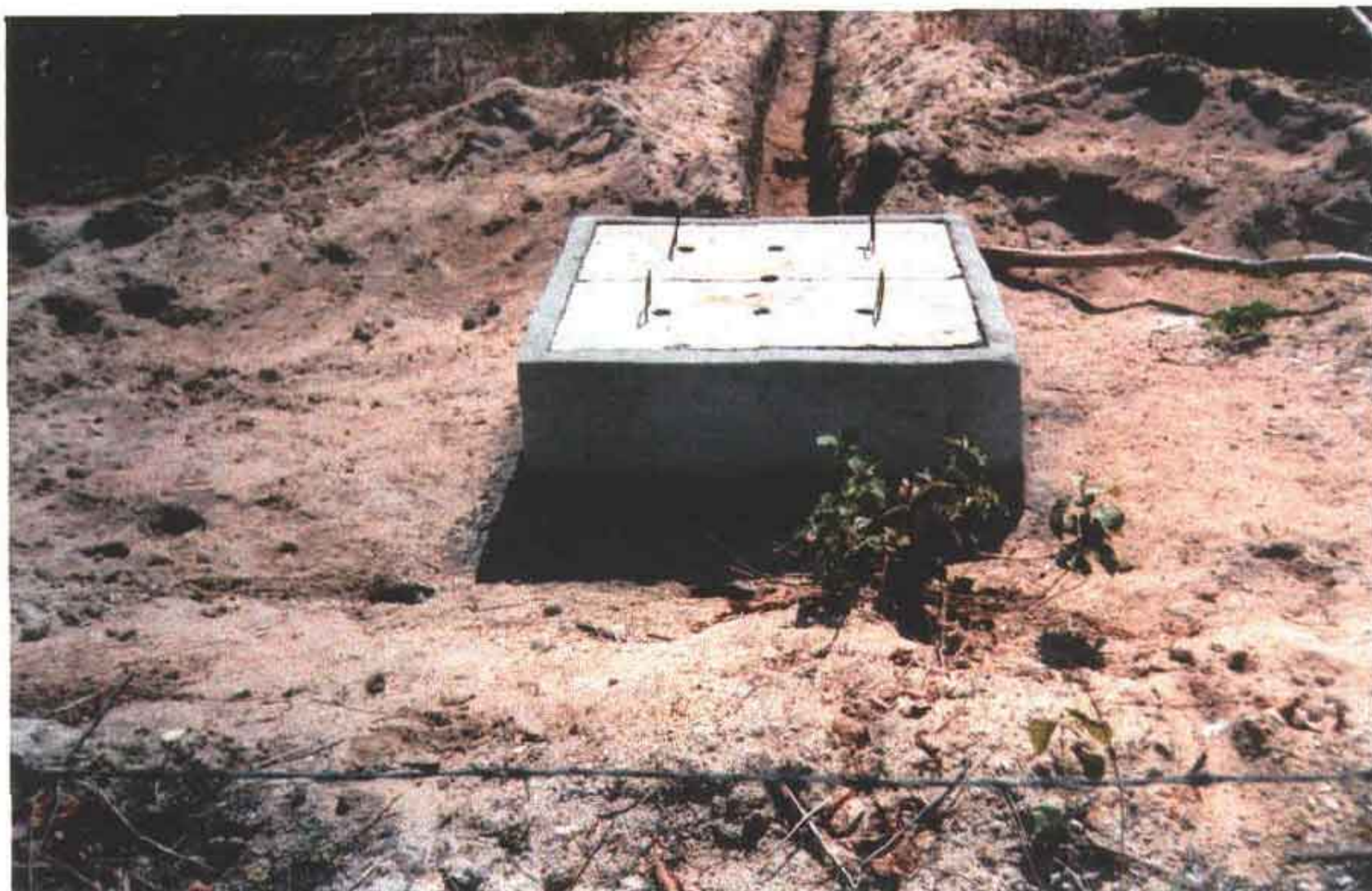
Foto 09 – Caixa para registro – Detalhe da tampa e da vala para o tubo de descarga.
