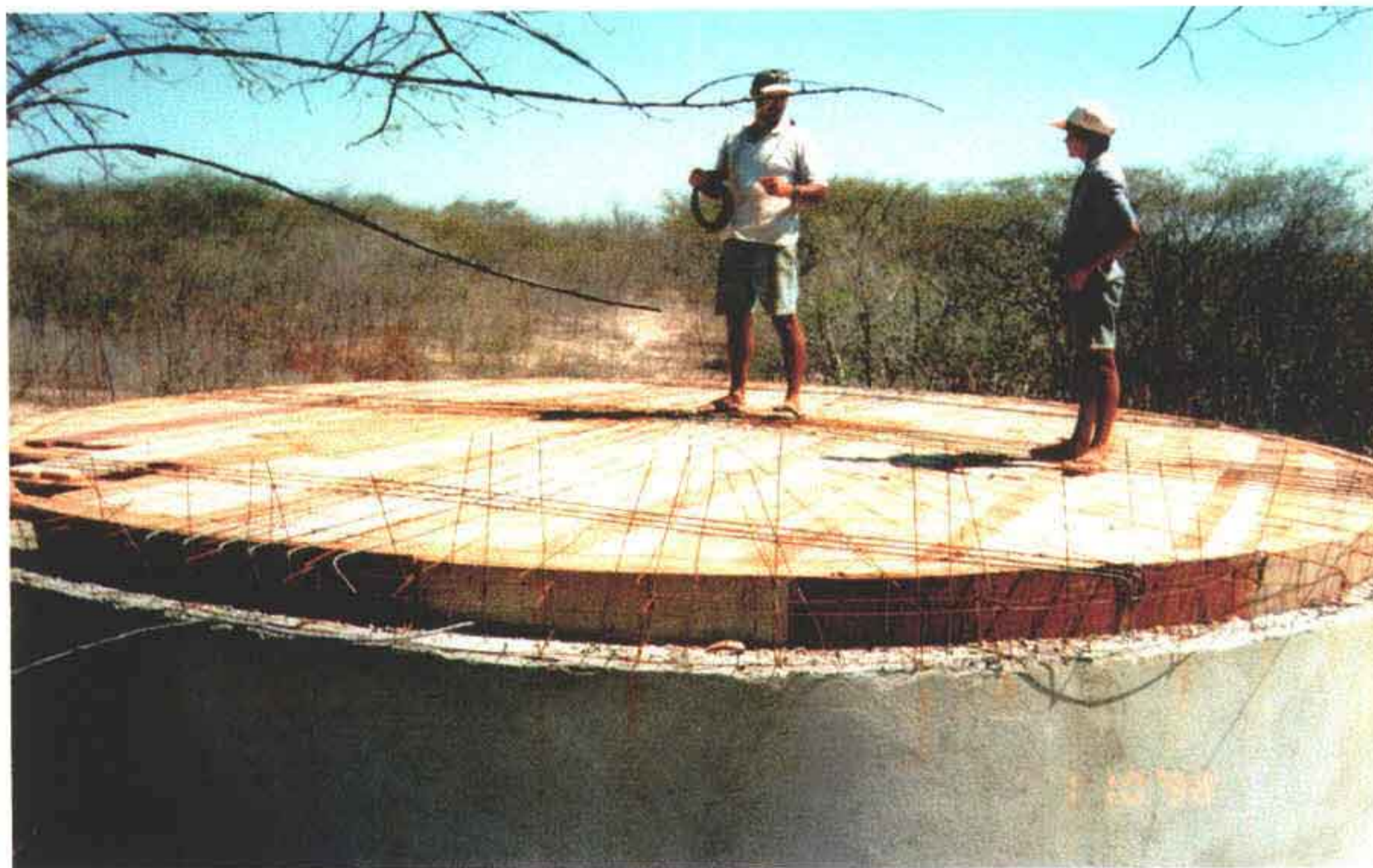
Foto 19 – Preparo da forma e ferragem da tampa do reservatório apoiado de 100 m 3 .
